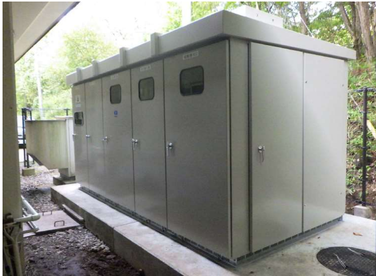
No.5 調布市八ヶ岳少年自然の家受変電設備改修工事 受変電設備 設置状況
