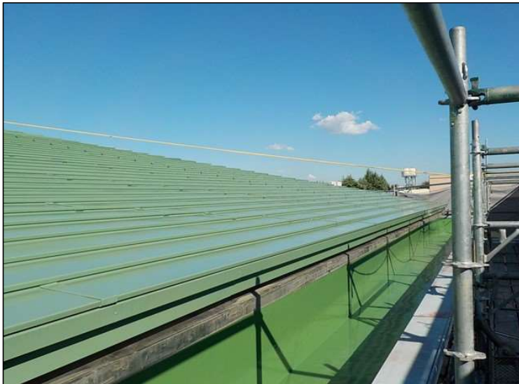
No.2 調布市立第三中学校第一体育館改修工事 屋根塗装工事 完了
