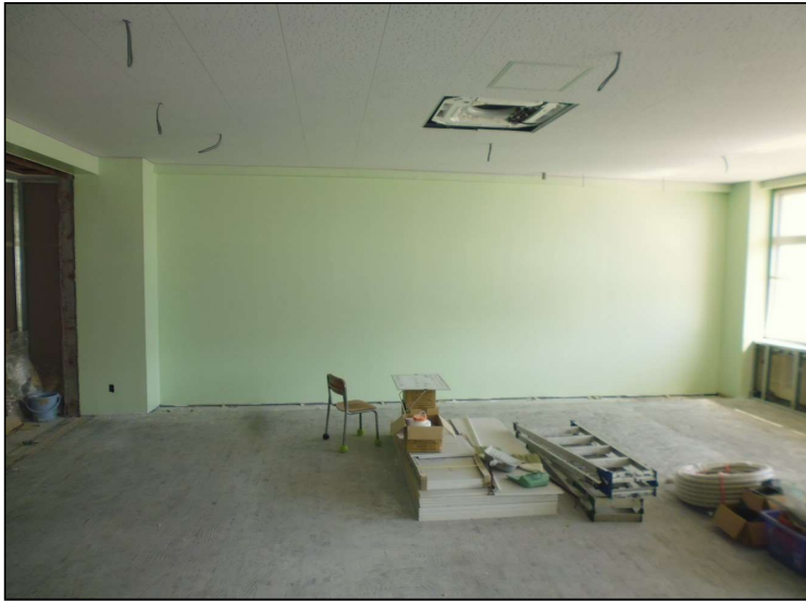
No.4 調布市立多摩川小学校普通教室整備工事 内装 撤去状況
