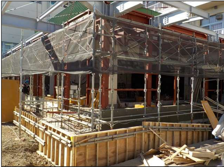
No.4 調布市立石原小学校給食室改修工事 鉄骨工事 施工状況
