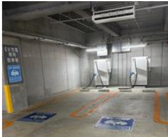
急速充電(35kW)×2基(2口)
