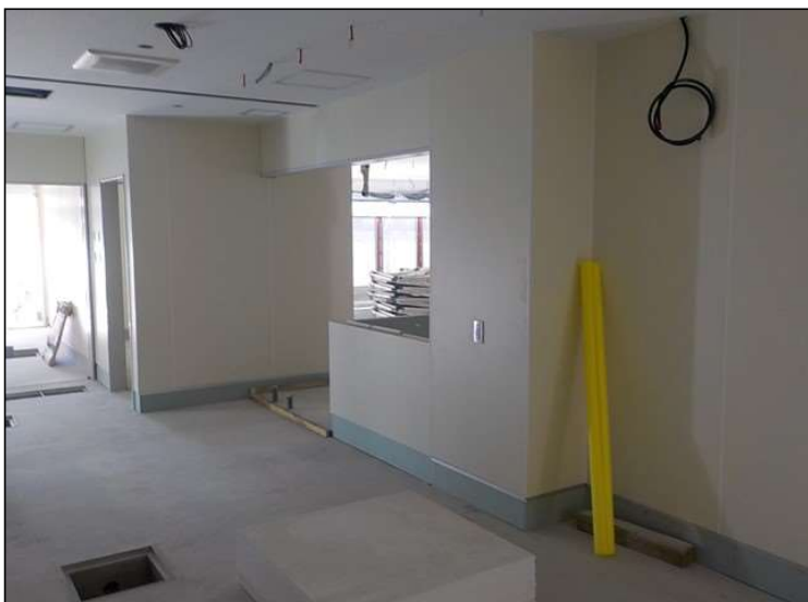
No.3 調布市立石原小学校給食室改修工事 下処理室内 施工状況
