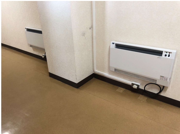
No.5 調布市八ヶ岳少年の家空調設備ほか改修工事 共用部 室内機設置状況
