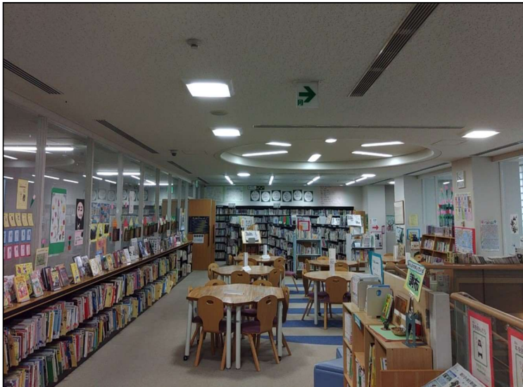
No.5 調布市立調和小学校校舎LED化改修工事(その2) 図書室内 工事完了
