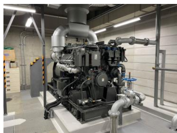
非常用発電機
