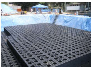
一次貯留施設(校庭貯留)
