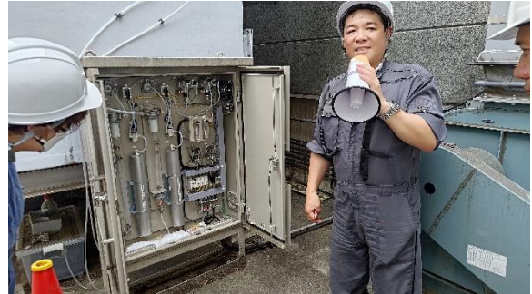
モニタリング設備
