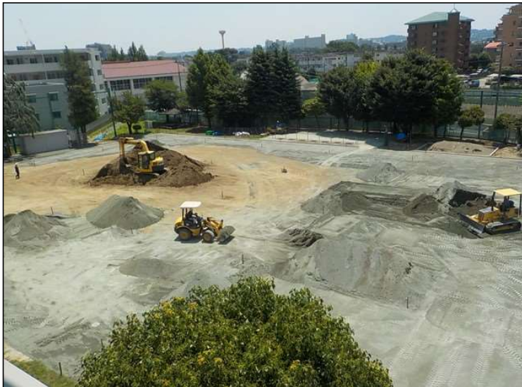
No.2 調布市立杉森小学校校庭整備工事 校庭内 施工状況
