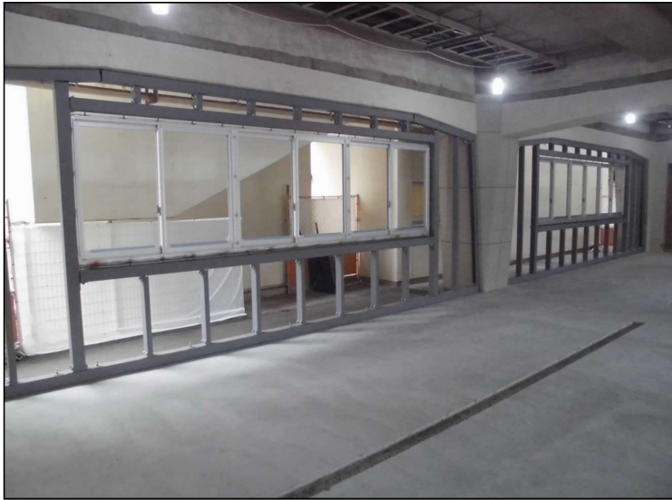
No.1 調布市立第一小学校普通教室整備工事 外壁下地 施工状況
