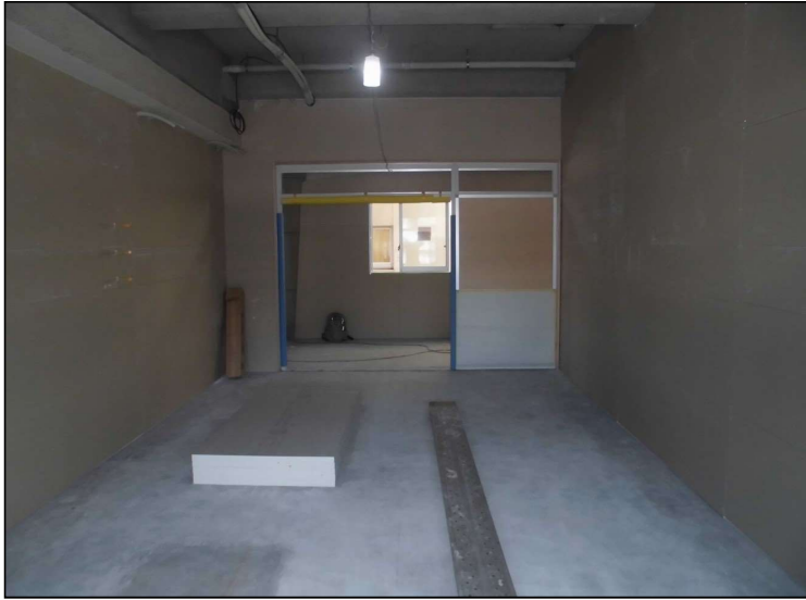
No.1 調布市立第一小学校普通教室整備工事 間仕切壁 施工状況
