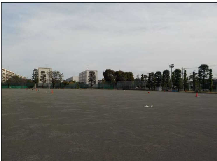
No.2 調布市立第三中学校校庭整備工事 校庭内 施工状況
