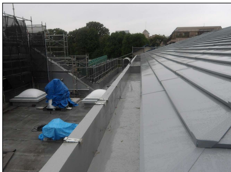
No.5 調布市立神代中学校格技棟改修工事 金属屋根 塗装状況
