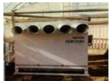
ヒートポンプの導入例
