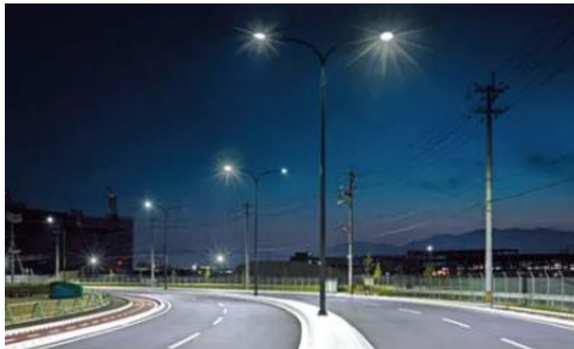
図 LED照明導入による消費電力削減
