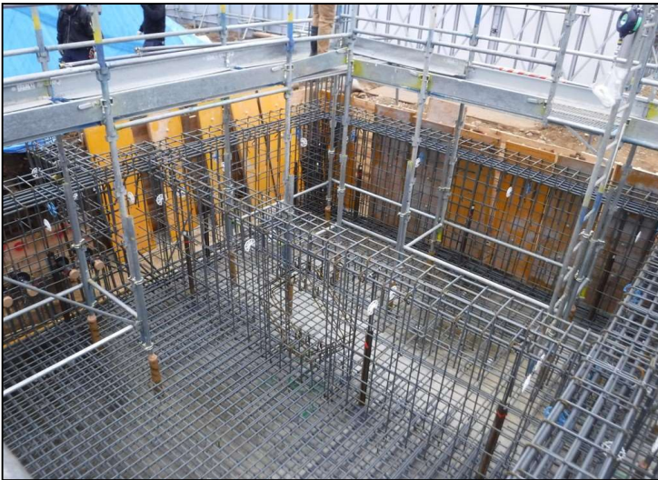
No.5 （仮称）調布市国史跡下布田遺跡ガイダンス施設新築工事 基礎 施工状況
