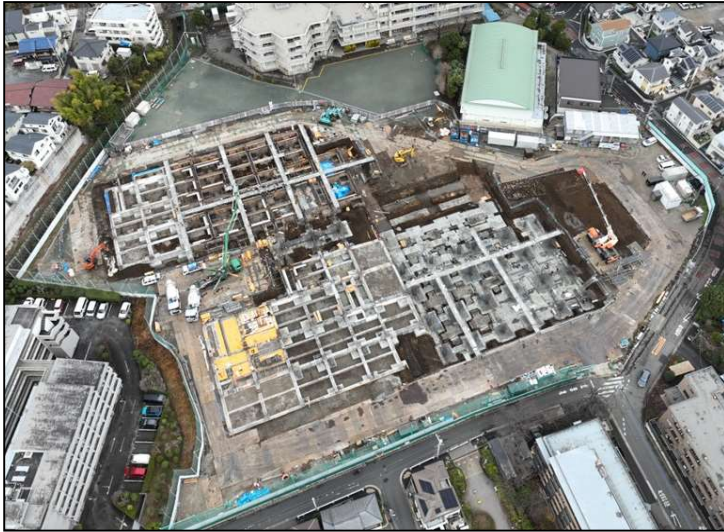
No.1 調布市立若葉小学校・第四中学校・ 図書館若葉分館施設整備PFI事業 基礎 施工状況
