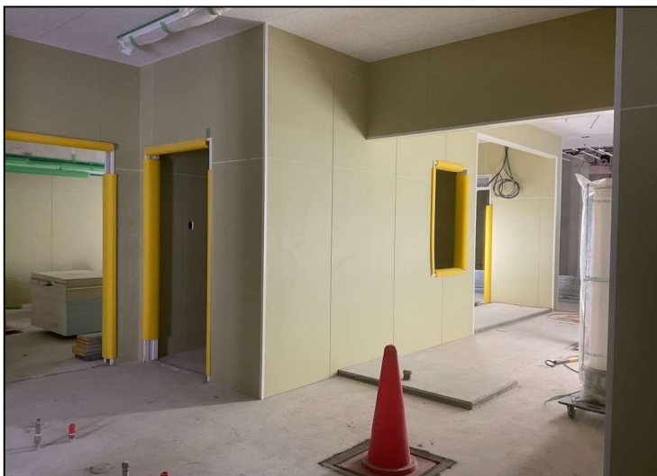
No.3 調布市立多摩川小学校給食室改修工事 内部仕上 施工状況
