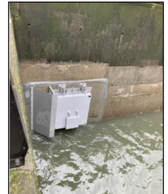
逆流防止ゲート （フラップゲート）
