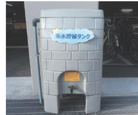
雨水貯留タンク
