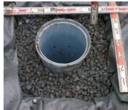
宅地内 雨水浸透ます
