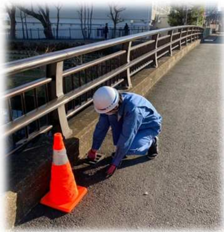
橋りょう上に堆積した土砂撤去や排水柵の清掃の様子
