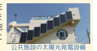
公共施設の太陽光発電設備
