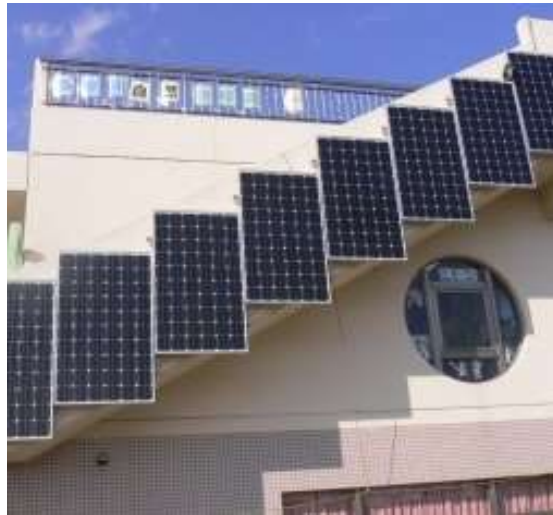
公共施設の屋根貸しによる太陽光発電事業
