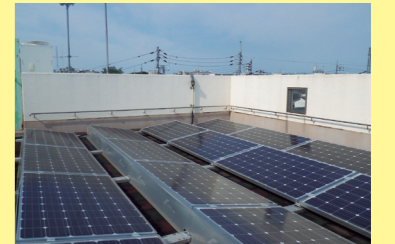
多摩川自然情報館屋上設置の太陽光パネル
