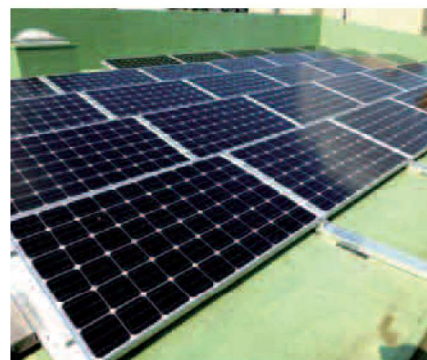
富士見地域福祉センター 屋上の太陽光パネル
