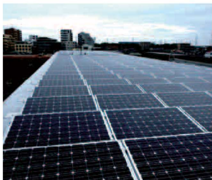
せんがわ劇場屋上の 太陽光パネル
