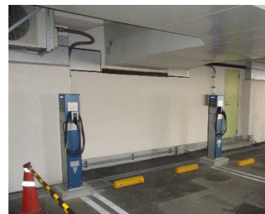
<EV充電スタンド>
