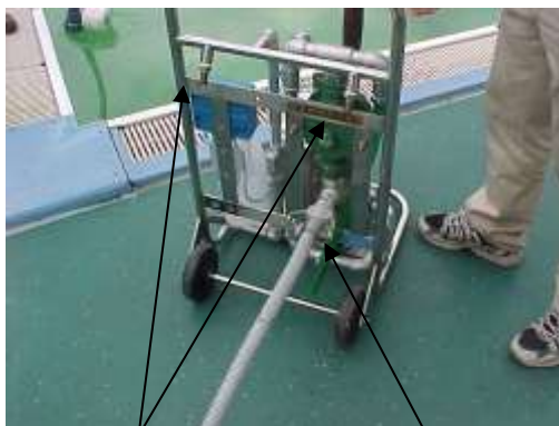
浄水ホース取付口 吸水管取付口
