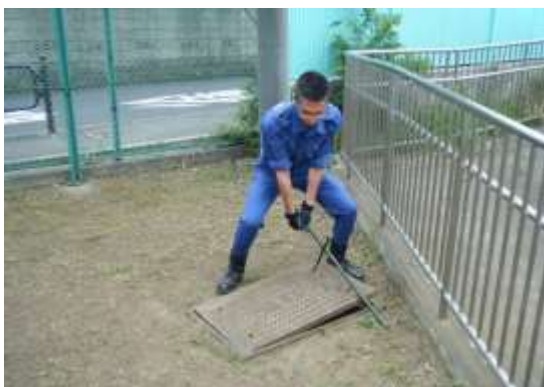
鍵の先端が鉄蓋の内側に引っかかるので、そのまま引き上げる。
