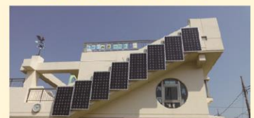
太陽光発電設備
