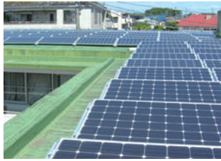
公民館屋上ソーラーパネル
