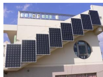
<公共施設の屋根貸しによる太陽光発電事業>
