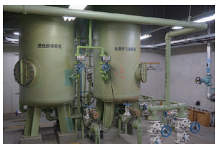
文化会館たづくりの雨水貯留槽設備
