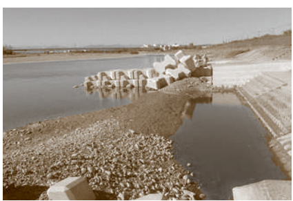
台風19号による多摩川の水制破損
