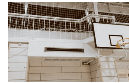
市立中学校体育館のエアコン
