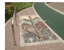
4. 凹凸のある舗装面
