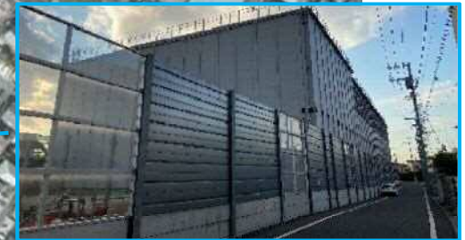
仮囲い(防音パネル) (構築済)
