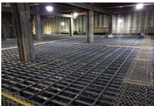
中央JCT南側開削トンネル頂版配筋施工状況 (令和4年5月15日)
