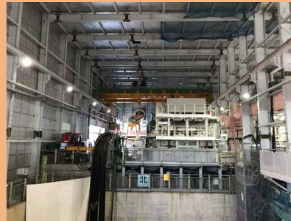
Fランプ防音ハウス内 (令和4年11月17日)
