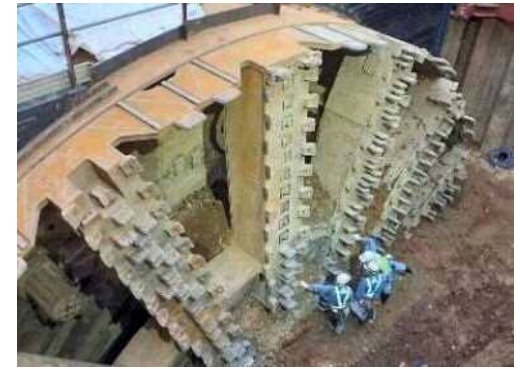
②損傷した部材等の確認
