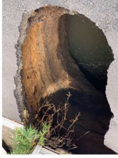
写真6 陥没箇所(2020年10月18日 13:00 西側から撮影)
