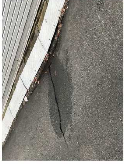
写真3 陥没箇所(2020年10月18日 11:50 舗装亀裂)
