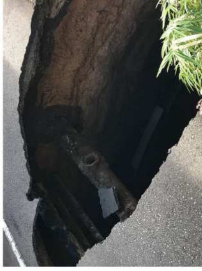
写真5 陥没箇所(2020年10月18日 13:00 東側から撮影)
