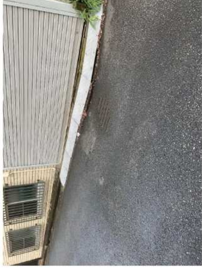
写真2 陥没箇所(2020年10月18日 9:30水たまり)
