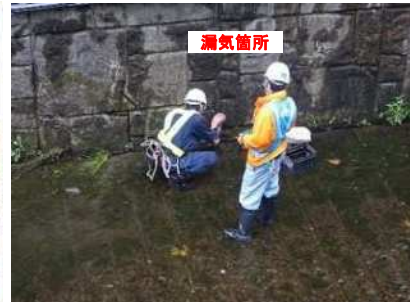
【白子川での漏気状況】
