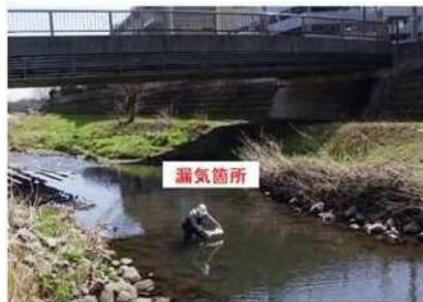
【野川での漏気状況】
