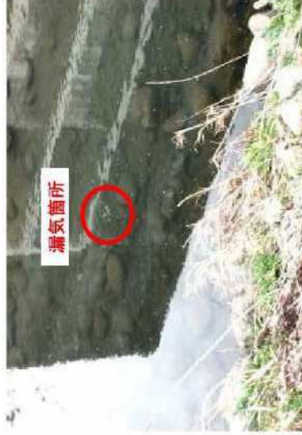
漏気状況①(3/7～4/24)
