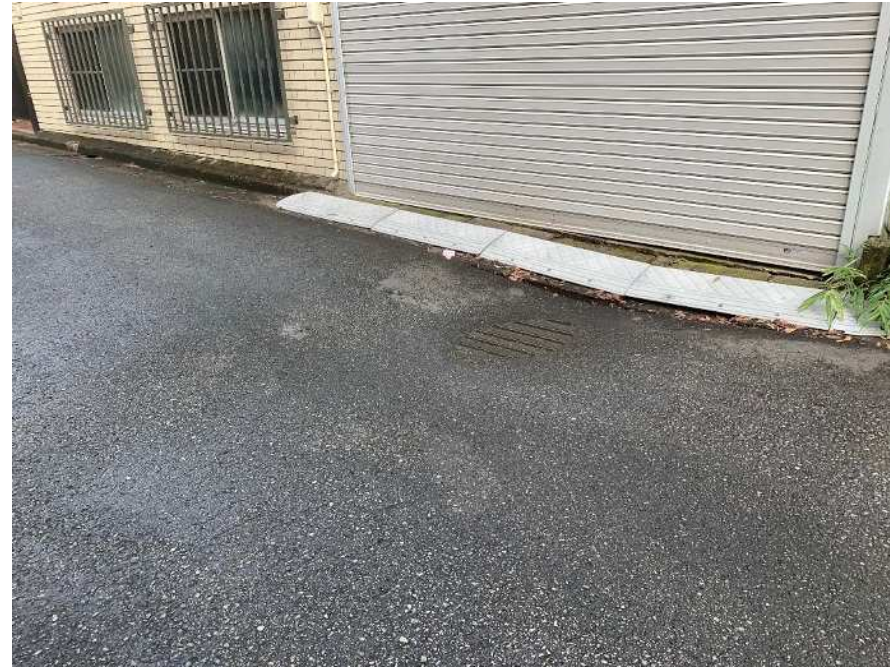
写真2 陥没箇所(2020年10月18日_9:30水たまり)
