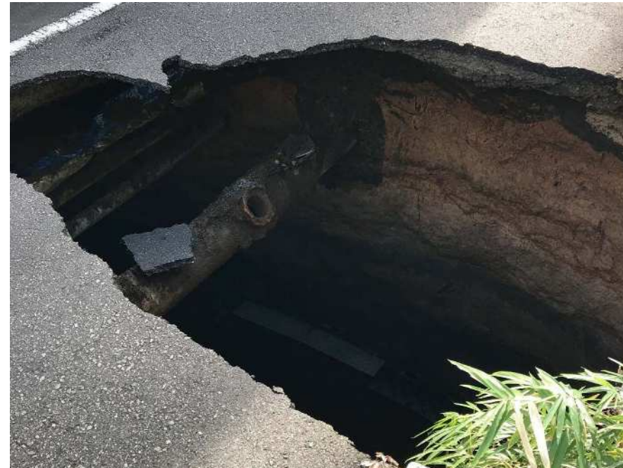
写真5 陥没箇所(2020年10月18日_13:00_東側から撮影)
