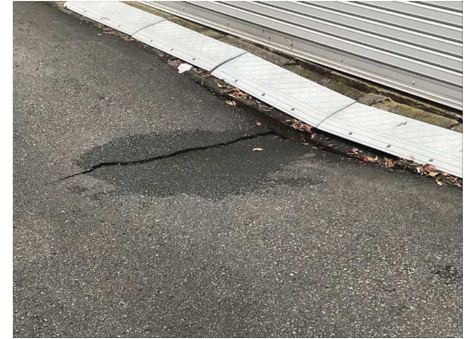
写真3 陥没箇所(2020年10月18日_11:50_舗装亀裂)
