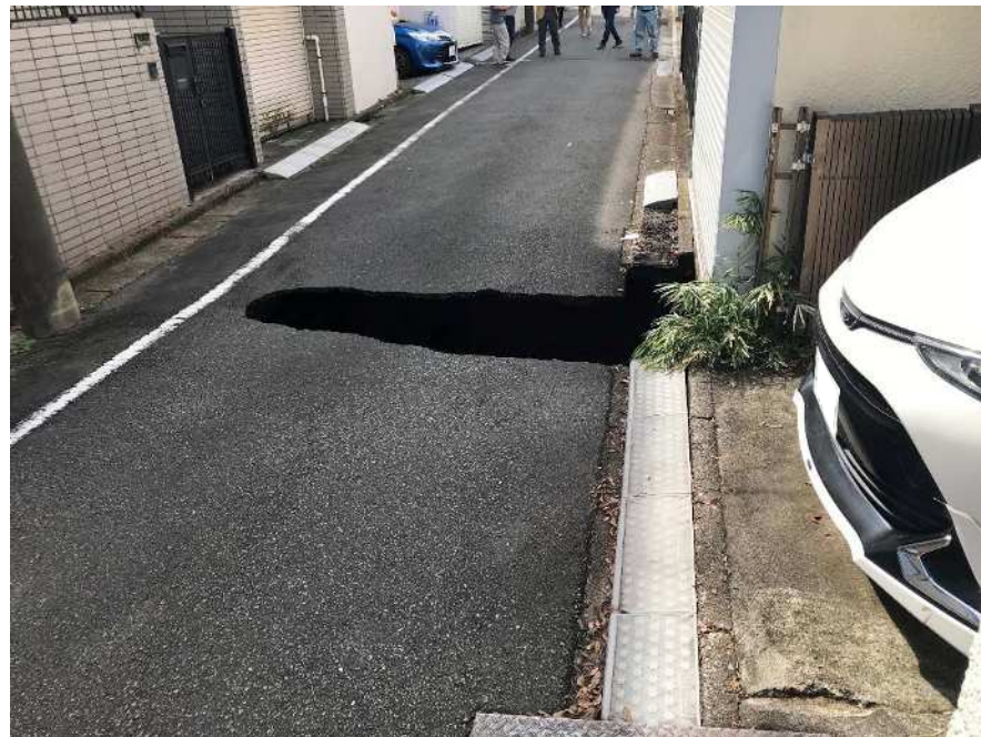
写真4 陥没箇所(2020年10月18日_12:30)
