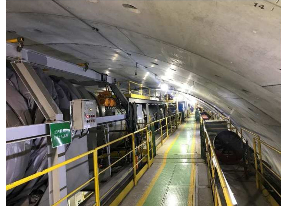
写真3 坑内状況写真(陥没位置付近右側)
