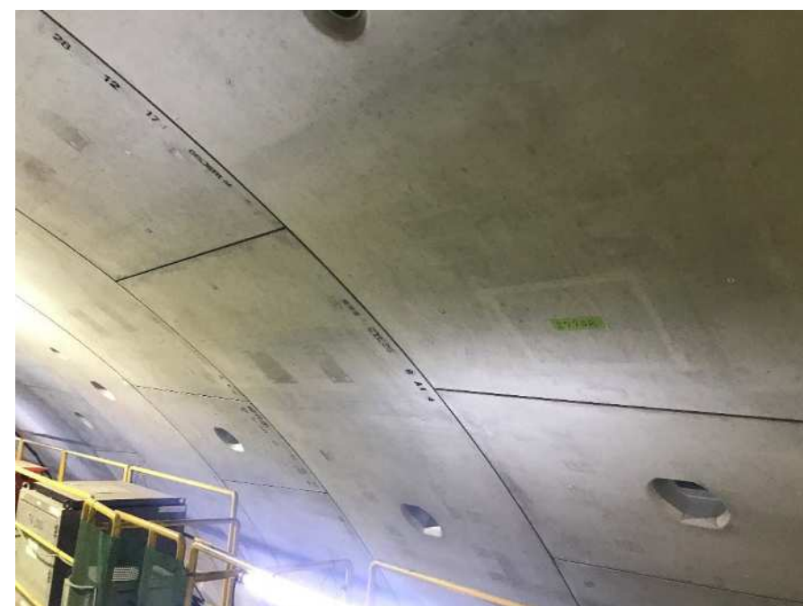
写真5 坑内状況写真(陥没位置付近セグメント状態)
