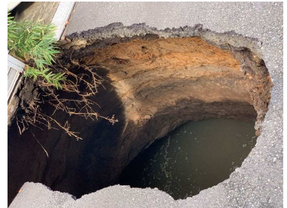
写真6 陥没箇所(2020年10月18日_13:00_西側から撮影)
