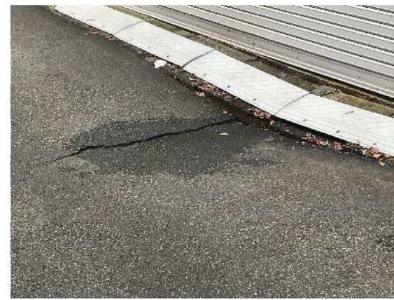
写真3 陥没箇所(2020年10月18日_11:50_舗装亀裂)
