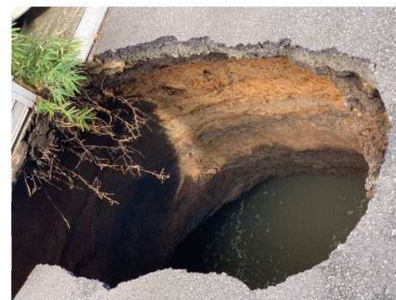
写真6 陥没箇所(2020年10月18日_13:00_西側から撮影)
