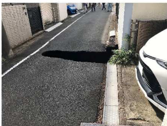
写真4 陥没箇所(2020年10月18日_12:30)
