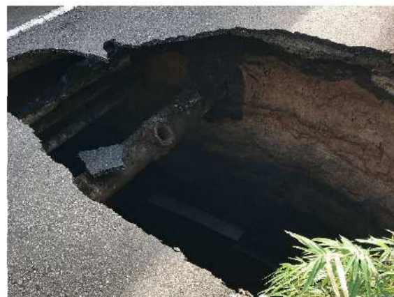
写真5 陥没箇所(2020年10月18日_13:00_東側から撮影)
