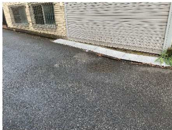
写真2 陥没箇所(2020年10月18日_9:30水たまり)
