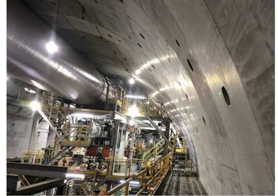
写真3 坑内状況写真(空洞発見箇所付近右側)
