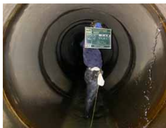
管路の水漏れ（浸入水の発生）
