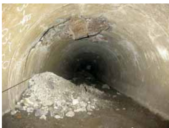
破損した管路
