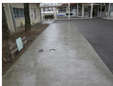
▲汚水柵が並んでいる様子
