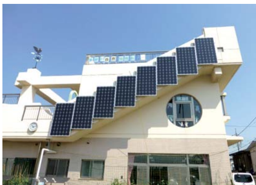
調布市多摩川自然情報館の壁面に設置された太陽光発電パネル
