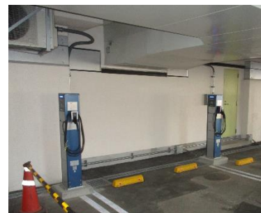
<EV充電スタンド>
