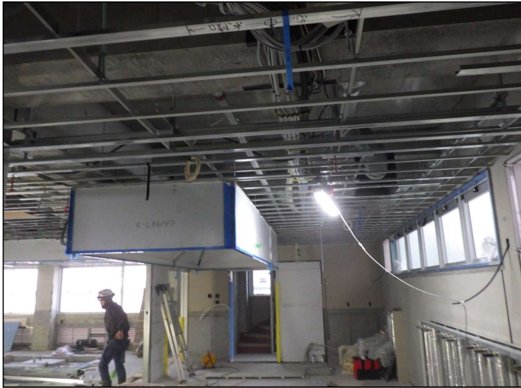
No.1 調布市立柏野小学校給食室改修工事 給食室内部 施工状況
