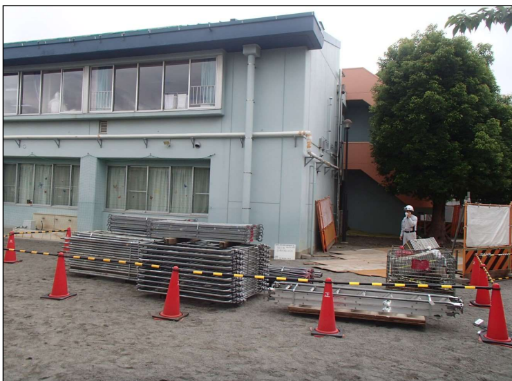
No.3 調布市西部公民館軒樋改修工事 仮設工事 着手状況
