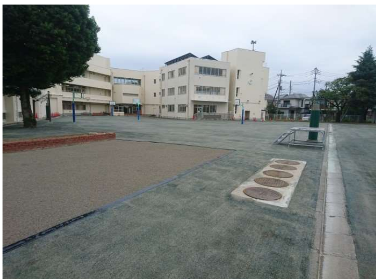
No.6 調布市立飛田給小学校校庭整備工事 校庭 施工状況
