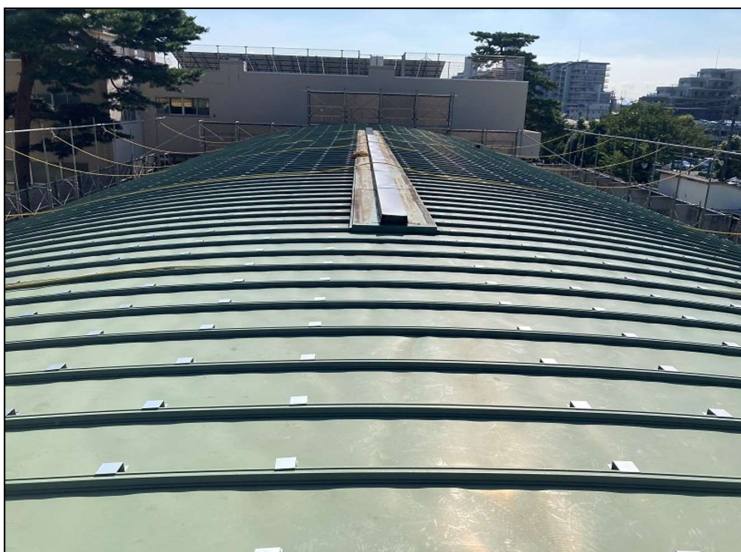
No.3 調布市立上ノ原小学校体育館外部改修工事 体育館屋根 施工状況
