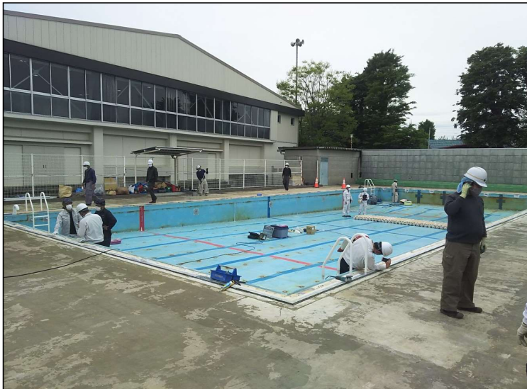
No.2 調布市立柏野小学校プール水槽ほか改修工事 プール水槽 施工状況
