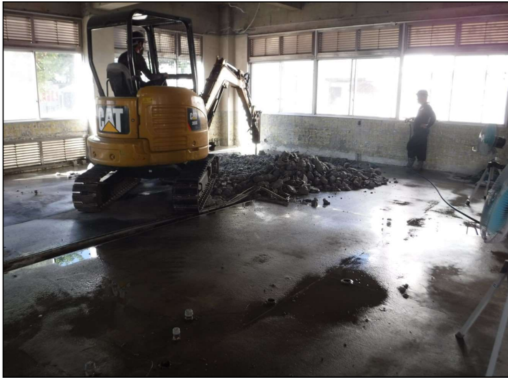
No.4 調布市立柏野小学校給食室改修工事 給食室内部 解体作業状況
