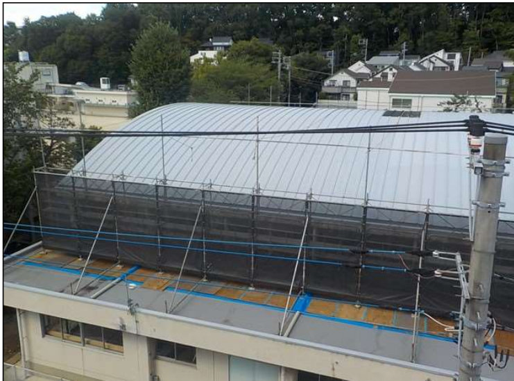
No.5 調布市立若葉小学校体育館屋根ほか改修工事 体育館屋根 塗装施工状況
